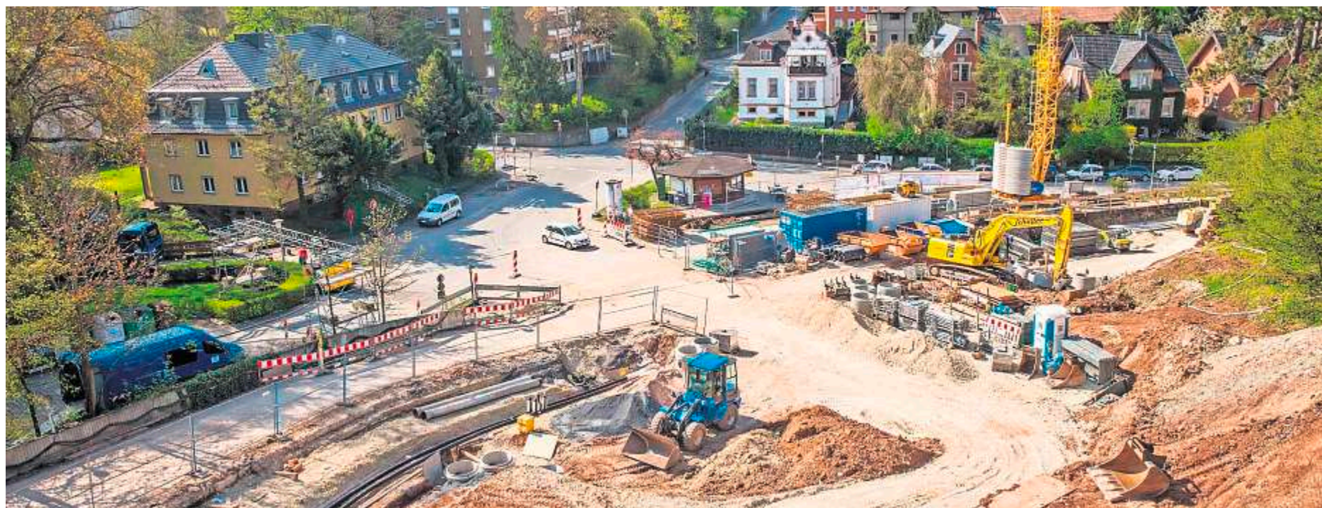
In der Leopoldstraße in Coburg sind die Bauarbeiten für das neue Wohnprojekt in vollem Gange. In den nächsten Jahren entstehen dort rund 100 neue Wohnungen. Foto: Frank Wunderatsch Seite 9
